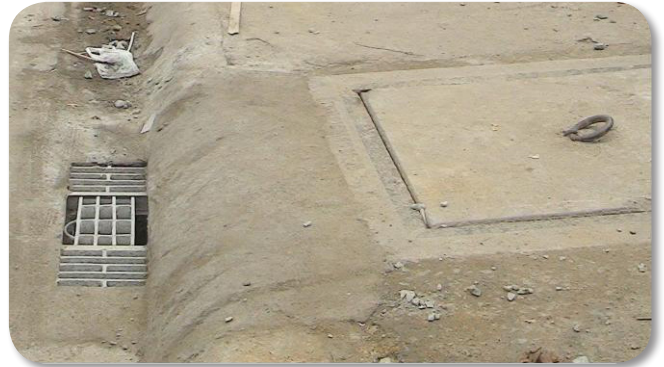
Miếng cống thoát nước có lưới chắn rác mới của Công ty HT.
