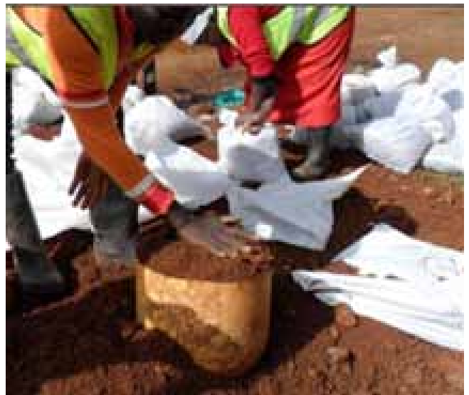
Bước 1: Dùng thùng đựng đất (hoặc vật liệu nhồi), khối lượng khoảng 20 - 25 kg tùy vật liệu sử dụng.
