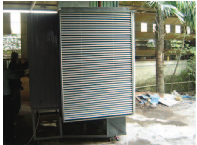
Hệ thống thông gió làm mát đoạn nhiệt áp suất dương
