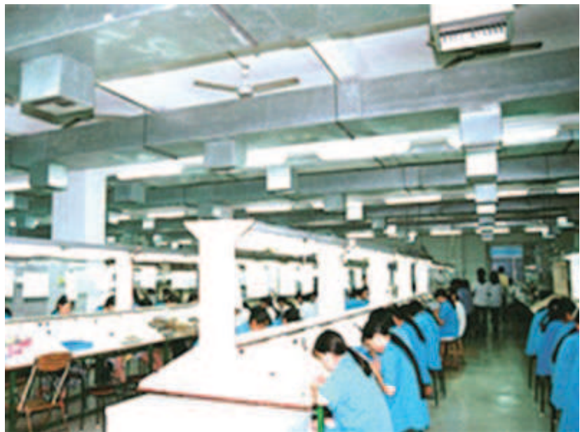
Hệ thống thông gió làm mát đoạn nhiệt áp suất dương trong xưởng may tại Cty Linh Phong
